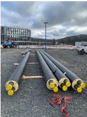
Ilustración 1: las tuberías están revestidas de un grueso aislamiento para ceder la mínima energía posible al exterior. Copyright: WIKUS-Sägenfabrik
