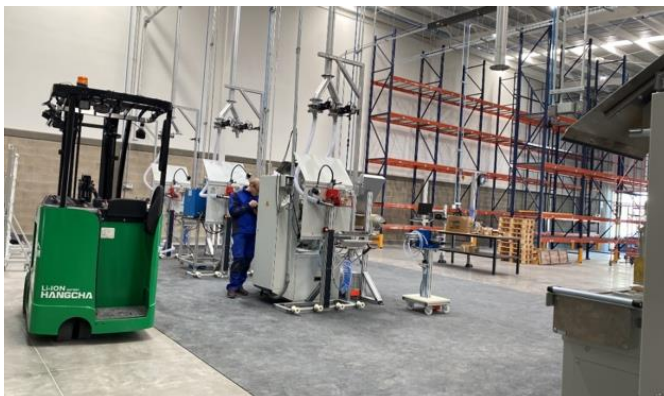
Abb. 3: Das neue Jahr 2024 startete umgehend mit der Installation des Maschinenequipments, das zuvor aus Deutschland eingeschifft wurde und die baldige Fertigung sicherstellt. Quelle: WIKUS-Sägenfabrik
